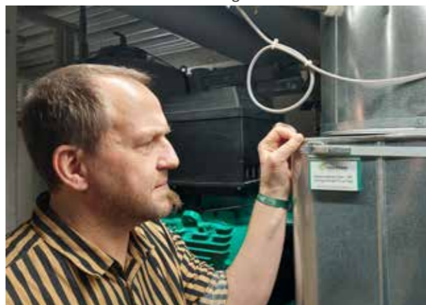
Schulleiter Ansgar Stich im Energiezentrum: Umsatz der Nahwärme aus der benachbarten Papiermühle in den Heizkreislauf des Johannes-Butzbach-Gymnasiums Miltenberg.
