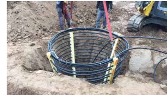
Der Erdwärmekorb Maxi von BetaTherm wird 3,90 m tief im Erdreich versenkt und liefert Wärme für die Wärmepumpe in der kalten Jahreszeit. Insgesamt vier Erdkörbe sind heute im Erdreich eines gut zu begehenden Gartens versteckt.
