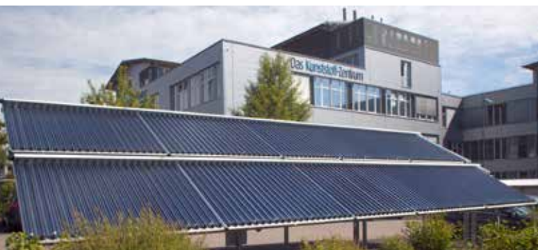
Bereits im Einsatz befindliche Solarthermieanlage zur Bereitstellung von Prozesswärme am SKZ.
