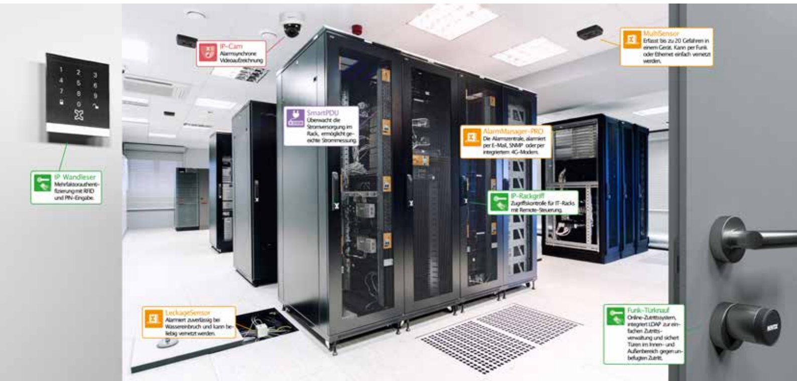
Beispiele für technische Maßnahmen zur Überwachung und zum Schutz von Serverräumen und -Schränken (Quelle: Kentix GmbH)
